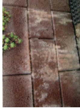
Ausblühungen an Blöckensteinen
