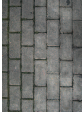
Ausblühungen auf Pflastersteinen
